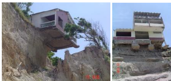
Figura 5. Afectación de viviendas por el retroceso del acantilado debido al incremento del nivel de mar (Soledispa, 2012).
