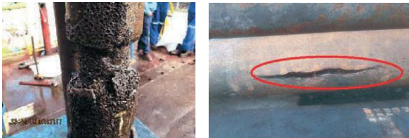
Figura 6. a) Sólidos en a entradas de las bombas, b) Huevo en tubería. Fuente: Petroamazonas EP.
