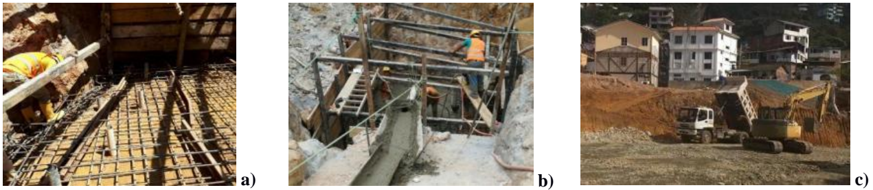
Figura 4: a) Replanteo + drenes + viga perimetral + armado de hierro. b) Fundición de losa. c) Relleno con material compactado Sub-Base clase 3
