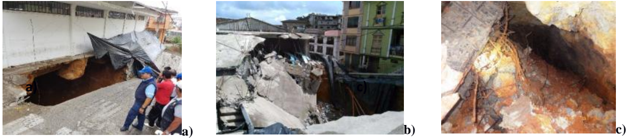
Figura 2: a) Inicio de colapso con un cono de 10 m. b) Desestabilización de estructuras. c) Escombros (columnas, mangueras, cables, bloques) dentro de la galería que provocó la subsidencia del terreno en superficie.
